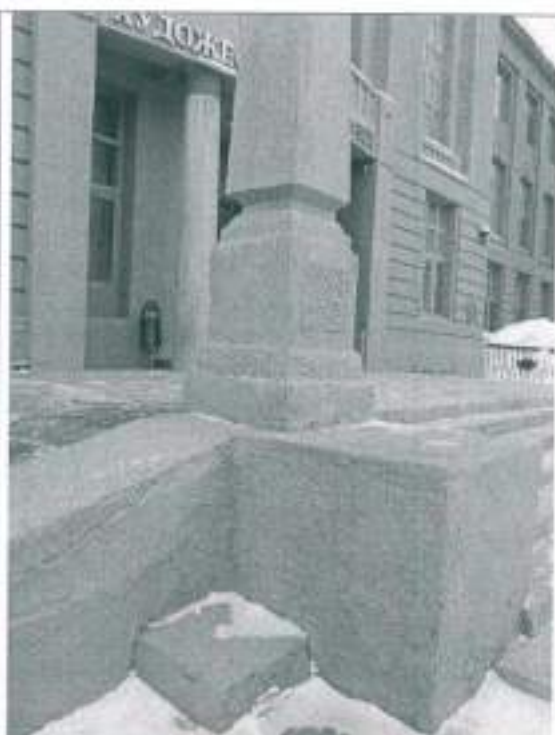
20. Дефекты отделочного слоя стенок пандуса и крыльца.
