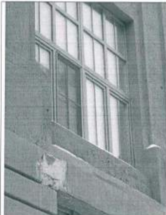
8. Дефект отделки стены южного (торцевого) фасада.
