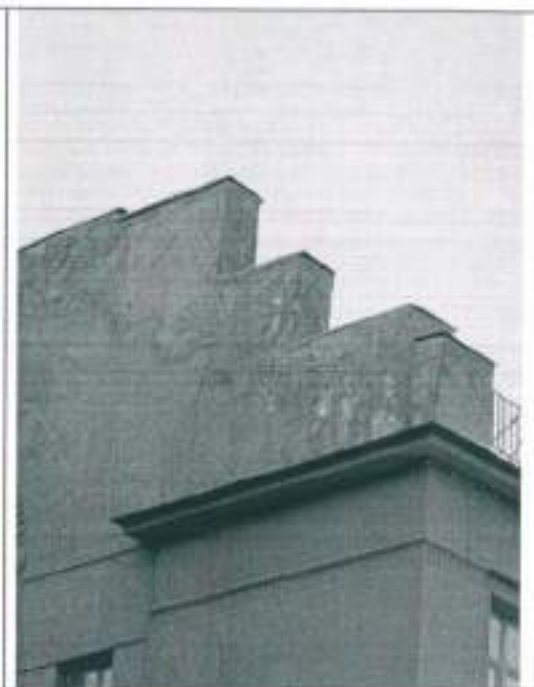
9. Нарушение отделочного слоя парадной стенок южного фасада.
