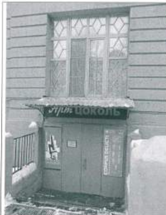
26. Оформление входа в цокольный этаж со стороны северного фасада. Современное окно с сохранением первоначального рисунка переплётов.
