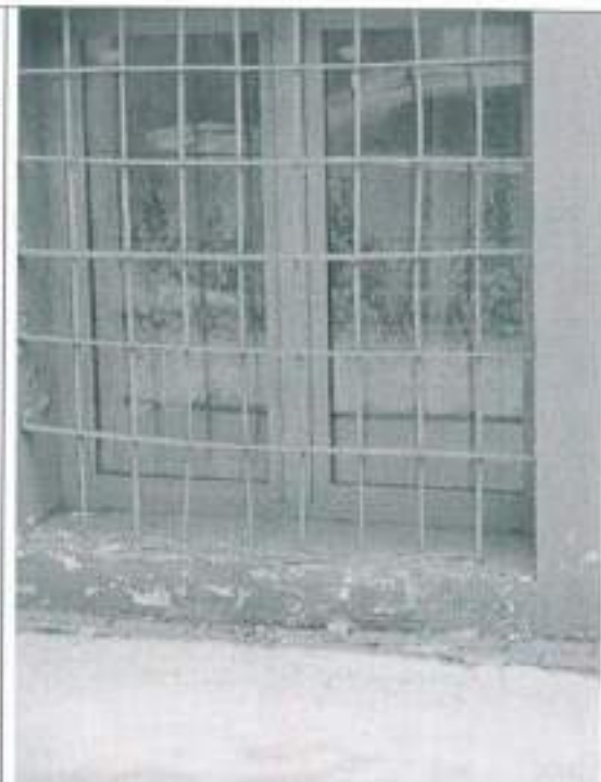
7. Дефект отделки стены цокольного этажа на западном фасаде южного крыла.
