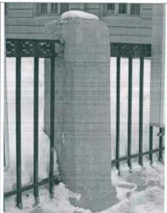
46. Дефекты столбика ограждения.
