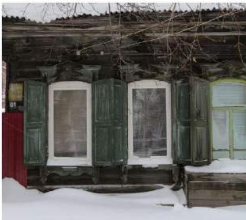
Вид и состояние наличников южного фасада. Январь 2018 года.
