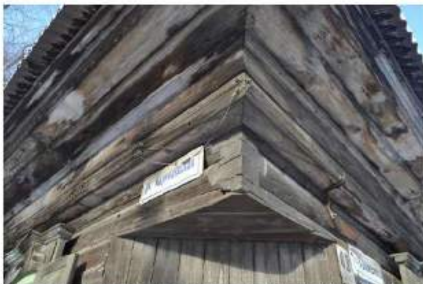
Вид и состояние врубки брёвен прямых венцов и досок карниза со стороны южного и восточного фасадов. Ноябрь 2018 года.
