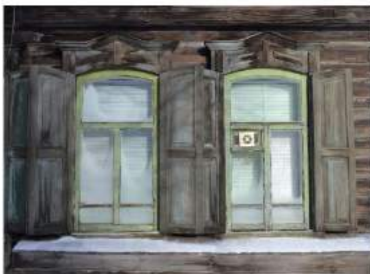
Вид и состояние оконных переплётов, ставен и наличников окон южного фасада. Ноябрь 2018 года.
