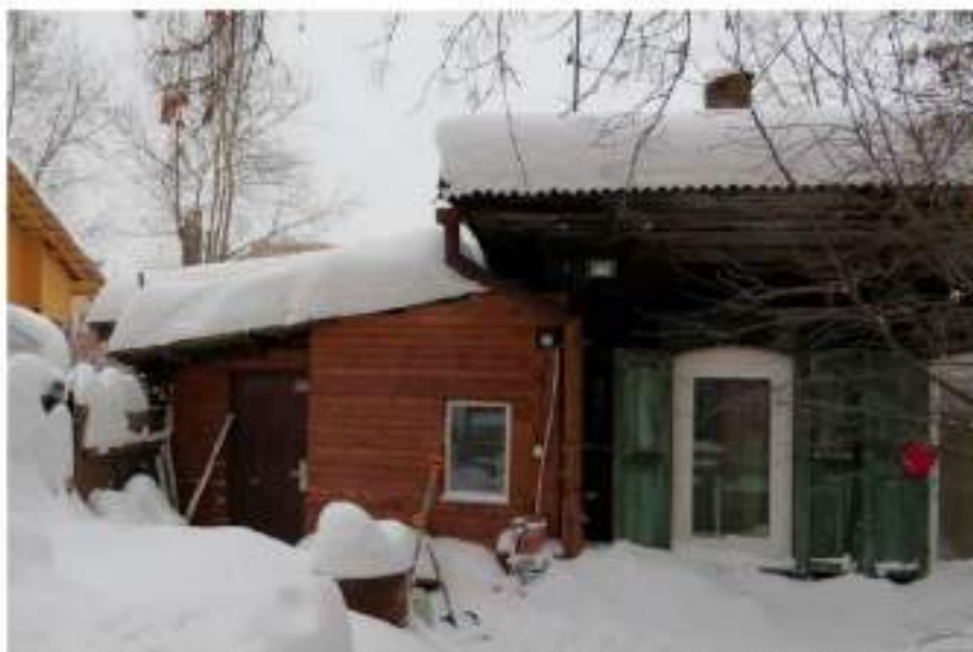
Вид и состояние фрагмента западного фасада и северной пристройки. Январь 2018 года.
