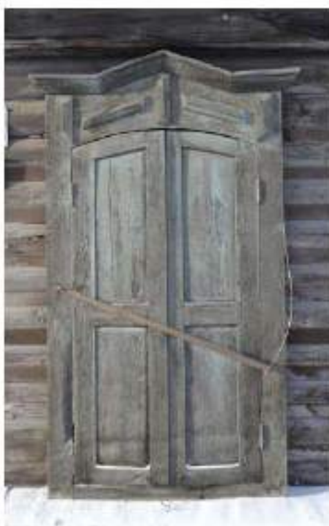
Вид и состояние палочка и ставен восточного фасада. Ноябрь 2018 года.
