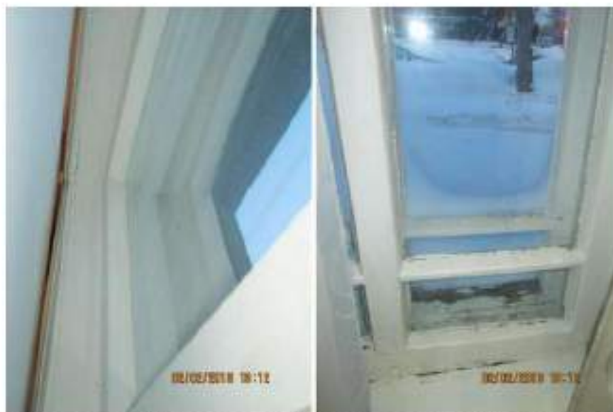
Вид и состояние фрагмента переплёта окна выходящего на восточный фасад. Февраль, 2018 год.
