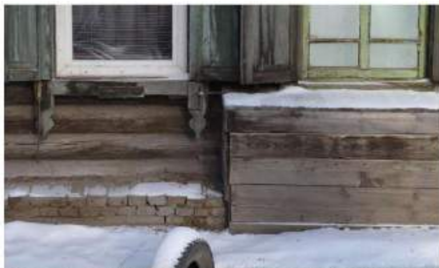
Вид и состояние фрагмента фундамента и завалитки южного фасада. Ноябрь 2018 года.
