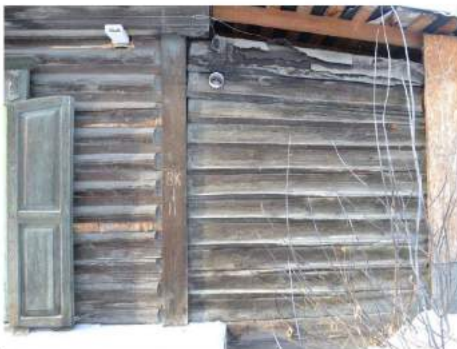
Вид и состояние совмещения основного сруба и стены входной зоны на восточном фасаде. Ноябрь 2018 года.
