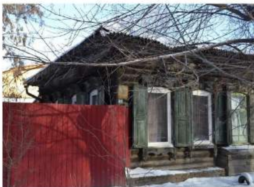
Вид и состояние фрагментов западного и южного фасадов. Ноябрь 2018 года.
