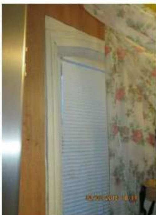
Вид и состояние наличника окна выходящего на восточный фасад. Февраль, 2018 года.
